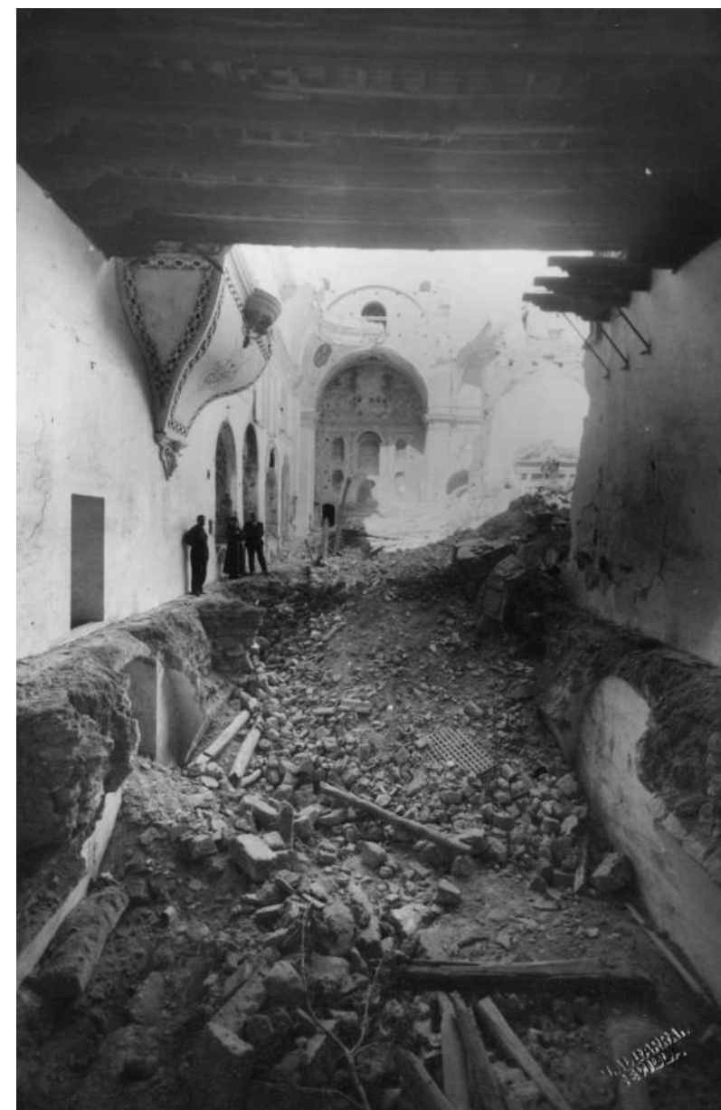
2. Vista desde los pies del interior de la iglesia del convento de Madre de Dios de Osuna tras el desplome de su techumbre en 1944. En el lado del evangelio se aprecia el muro del testero de la capilla de la Concepción. Fototeca Laboratorio de Arte. Universidad de Sevilla.
